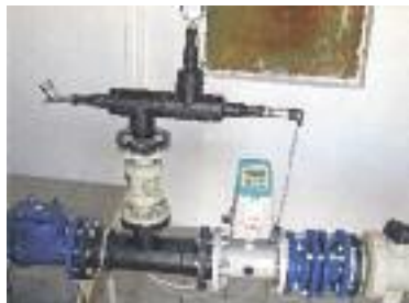
Instalație hidraulică și de control a unui puț de captare a apei reabilitat
